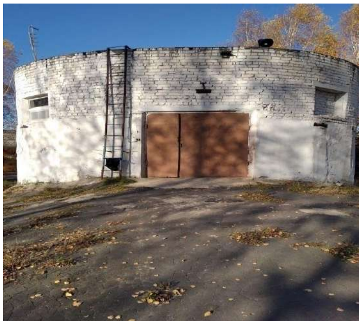
Канализационная насосная станция КНС -2
